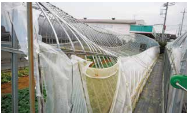
図3 突風により破損したパイプハウス(八潮市)
